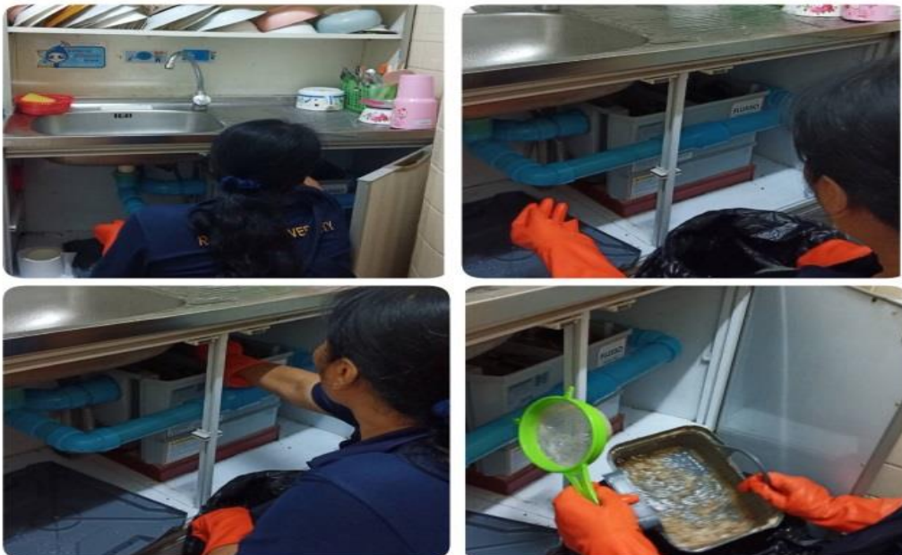
รูปที่ 15 การดูแลทำความสะอาดถังดักไขมัน
